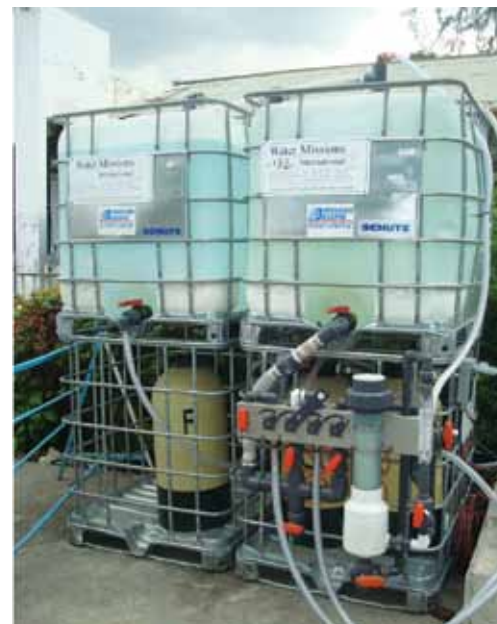
Sistema de tratamento de água usado pelos médicos
